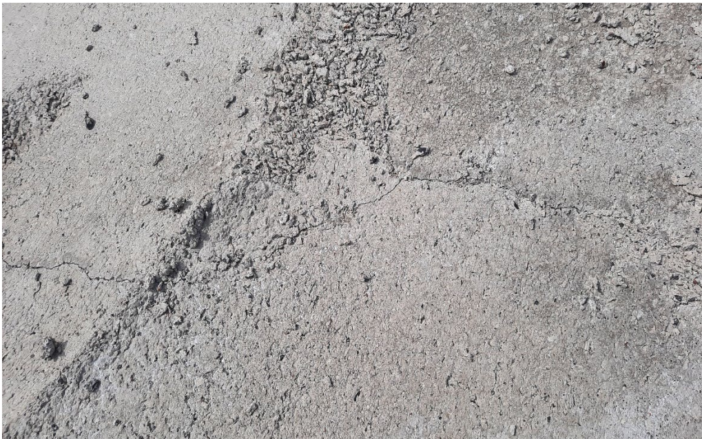
Kuva 1. Rakenteessa oleva halkeama
