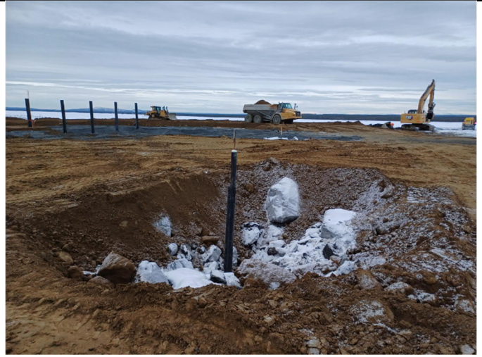
Kuva 15. Alueelle on asennettu pietsometrejä, joilla mitataan huokospainetta sekä painumatankoja (6.11.2024).
