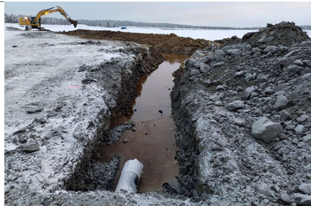
Kuva 3. Lohkon FP4 purkukaivon purkuputki ja purkuoja (20.11.2024).
