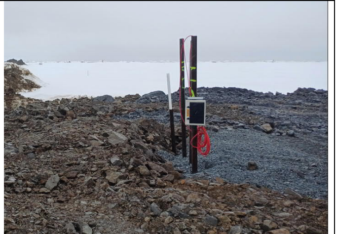
Kuva 8. Alueelle on asennettu pietsometrejä, joilla mitataan huokospainetta (10.4.2024).
